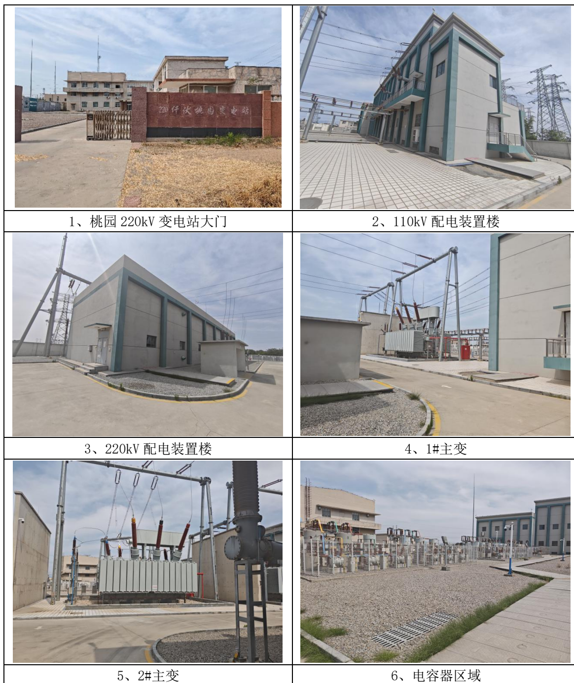
图 4-3 桃园 220kV 变电站站内现场照片
