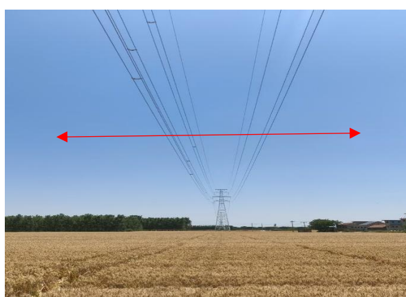
110kV红薛线19#塔~20#塔/110kV阜红线72#塔~71#塔双回架空线路两侧衰减
