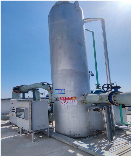
工艺废气二级水喷淋吸收塔
