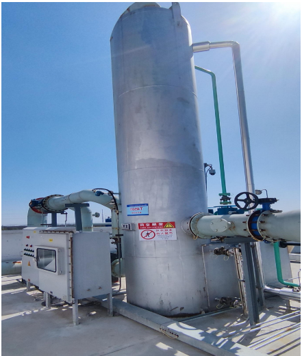
工艺废气二级水喷淋吸收塔
