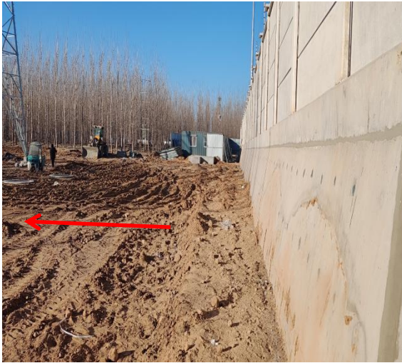
孟真 220kV 变电站南侧衰减
